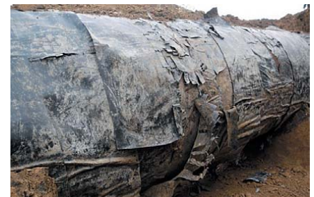
Рис. 1. Состояние пленочного покрытия после 30 лет эксплуатации
